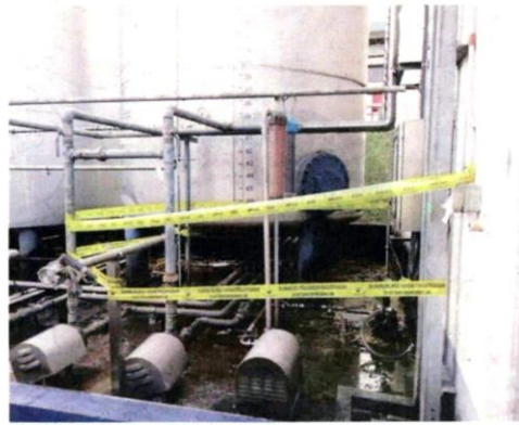
JAS mengarahkan operasi kilang di Balakong dihentikan sementara.
