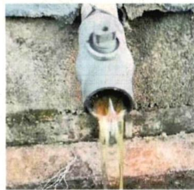
油槽喉管松脱后, 植物油泄漏。
